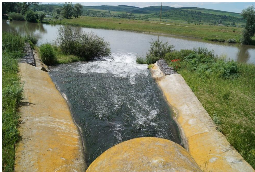
Evacuare stație de epurare Târgu Mureș (Foto AQUASERV)
