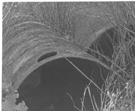
Foto 5. Porțiune din conducta DN 800 dezafectată din Stația de tratare, corodată la interior și la exterior
