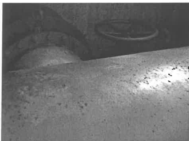
Foto 4. Conducta DN 1200 în căminul de vane. Coroziune exterioară
